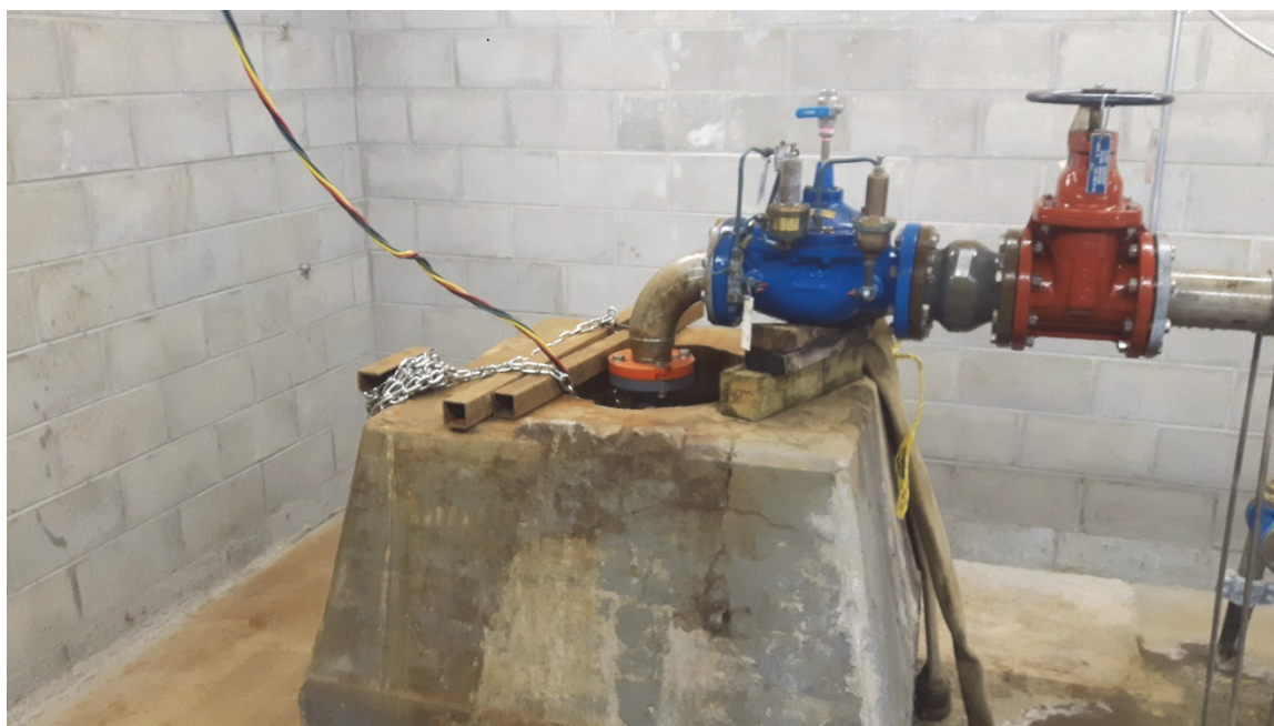
Photo 1 : Aperçu du puits municipal - 2020-09-17
